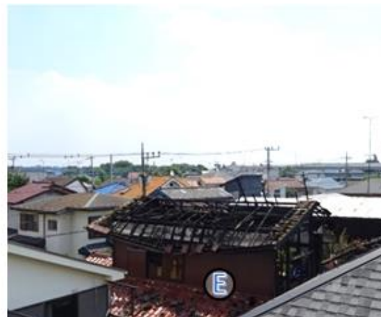
写真2.4.2-6 住宅Eの焼損状況
